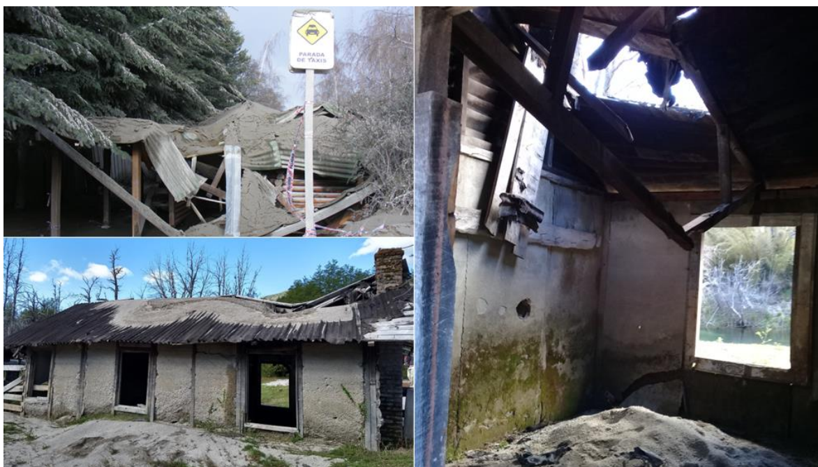
Figura 1.7. Ejemplo de colapsos de techos debido a la carga estática vertical generada por el depósito de caída de tefra de la erupción del Cordón Caulle de 2011-2012. Arriba a la izquierda, en los alrededores de Villa La Angostura. Abajo y a la derecha, en los alrededores del Paso Internacional Cardenal Samoré.
