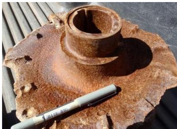
Figura 1.9. Ejemplo de los efectos corrosivos causados por la ceniza volcánica sobre las bombas impulsoras utilizadas en la planta de tratamiento de aguas residuales de la ciudad de Bariloche, luego de la erupción del Cordón Caulle de 2011-2012. Cortesía de C. Stewart.
