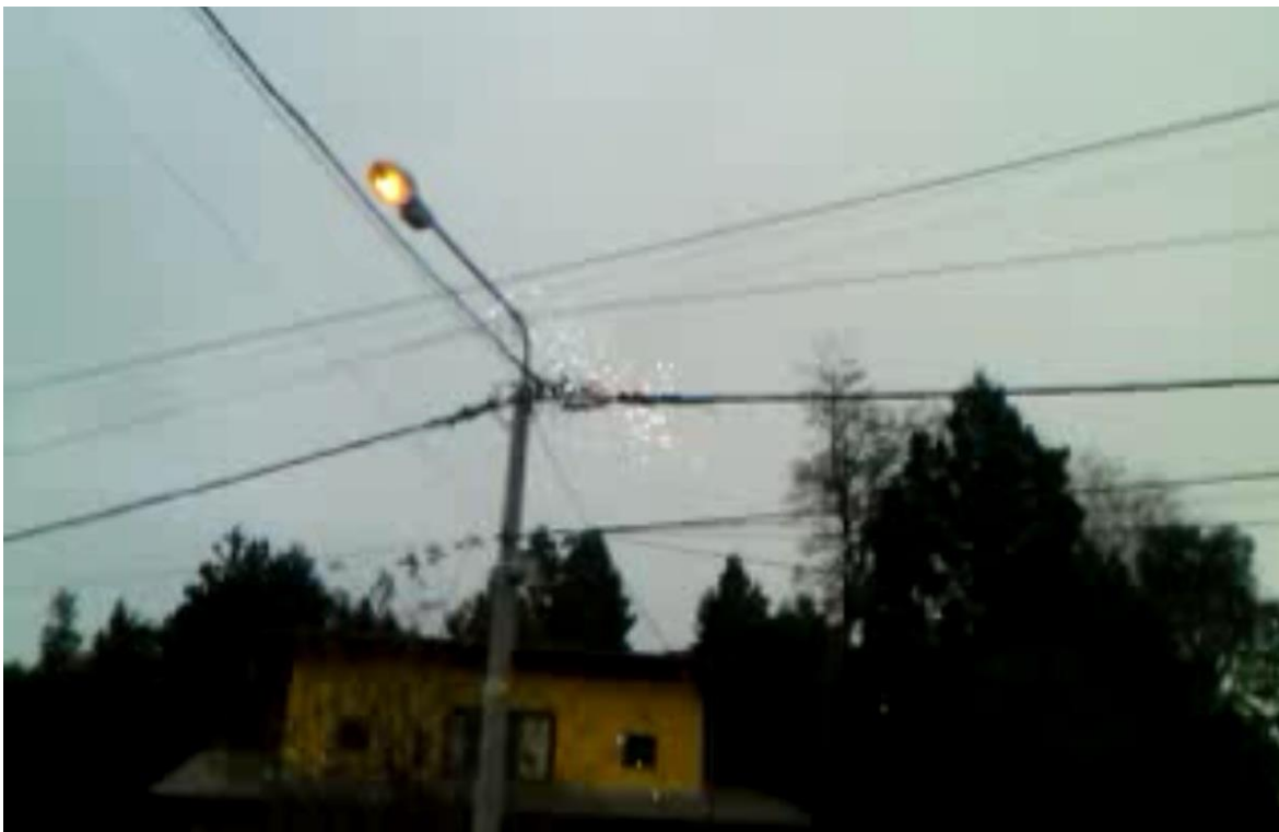
Figura 1.10. Ejemplo de fallos en los aisladores utilizados en los sistemas de distribución de energía eléctrica, a causa del efecto conductivo de la ceniza volcánica en húmedo. Fuente: video capturado por G. Villarosa frente al Centro Regional Universitario de Bariloche, durante la caída de ceniza volcánica del Cordón Caulle de 2011.
