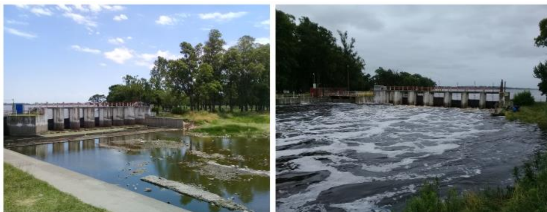
FIGURA 2-7. DIQUE REGULADOR DE LA LAGUNA DE NAVARRO, NACIMIENTO DEL ARROYO LAS GARZAS.
