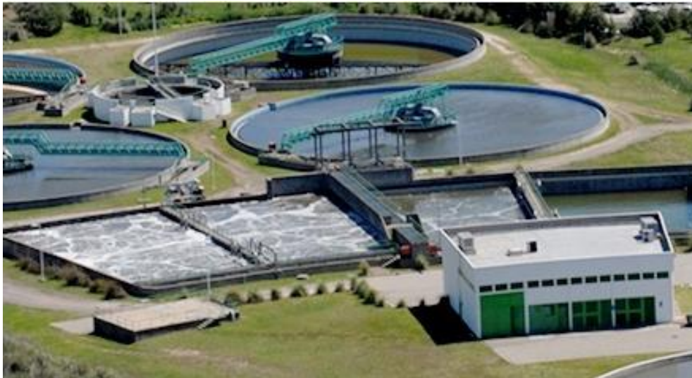
Figura 4. Fotografía de las unidades operativas correspondientes a la etapa de tratamiento secundario (barros activados) pertenecientes al módulo I de la planta en estudio. Cada módulo consta de cuatro cámaras de aireación y cuatro sedimentadores secundarios.
