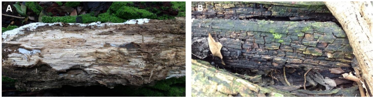
Figura 11. Aspecto de la madera degradada. A. Pudrición blanca y B. pudrición castaña.
