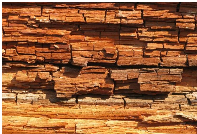
Figura 12: Madera atacada por un hongo causante de pudrición marrón. Fuente: www.uspest.com
