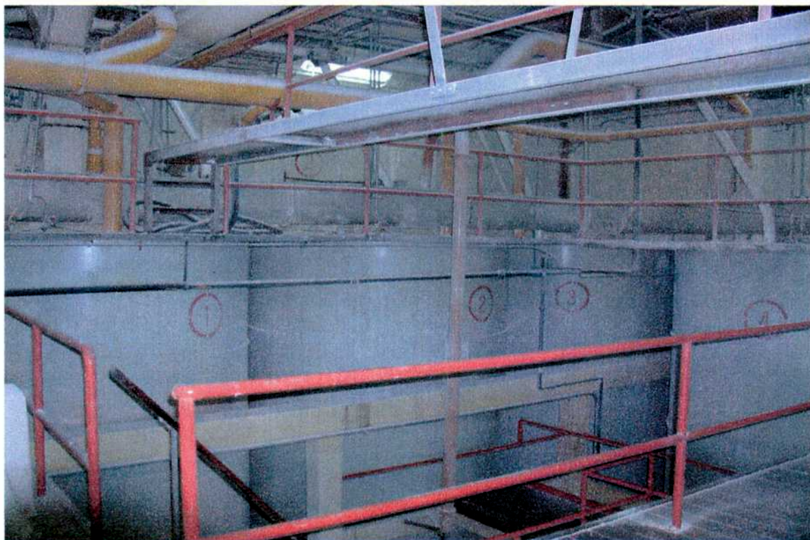
Figura V.7 Tanques o silos de acondicionamiento.
